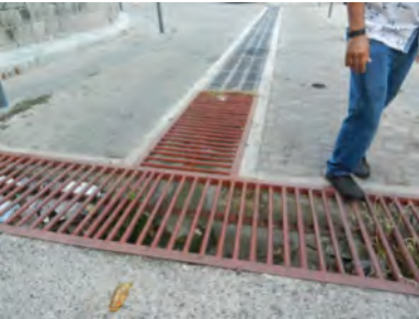
Imagen IV. 29. Drenaje central continuo
